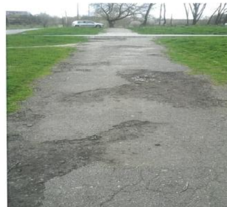
Górna część chodnika z mocno zniszczoną nawierzchnią
